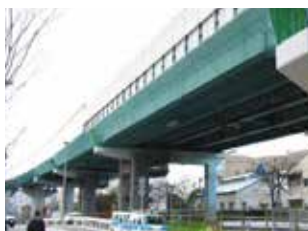
剥落防護ネット
