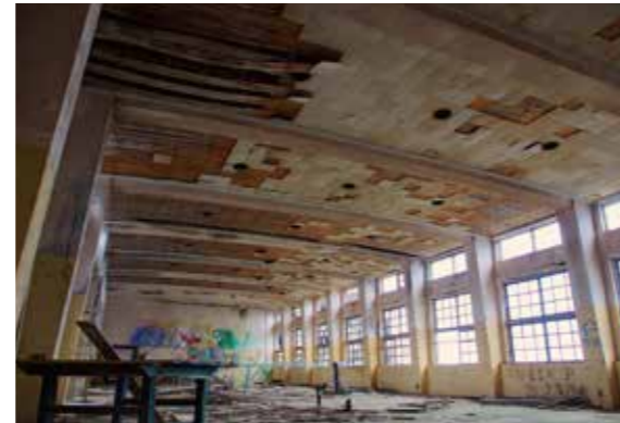
大規模ホールの天井落下事例
